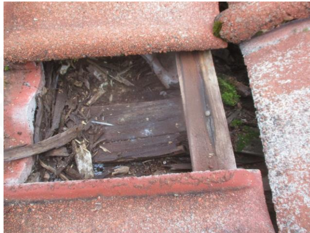
Kuva 4c. Lahoja vuotokohdan alla.
