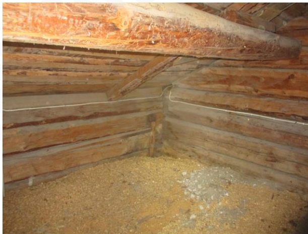
Kuva 4i. Vanhoja kosteusjälkiä salvoksessa.
