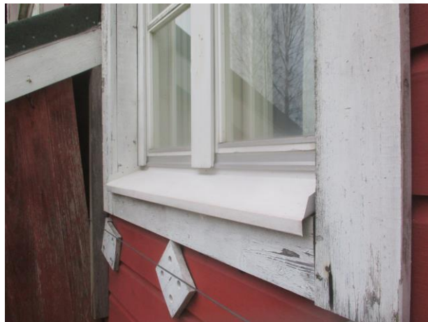
Kuva 3d. Uudempi ikkuna ja vesipellitystä. Vesipellitystä ei ole asennettu vuorilaudoituksen alle.
