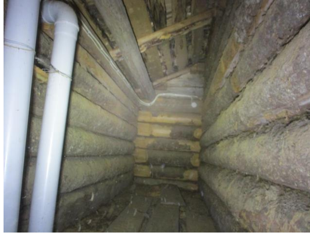
Kuva 4j. Vieriullakkoa. Iv-kanavat on eristämättä.
