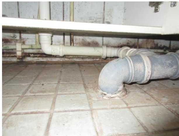
Kuva 5d. Allaskaapin alaosaa.
