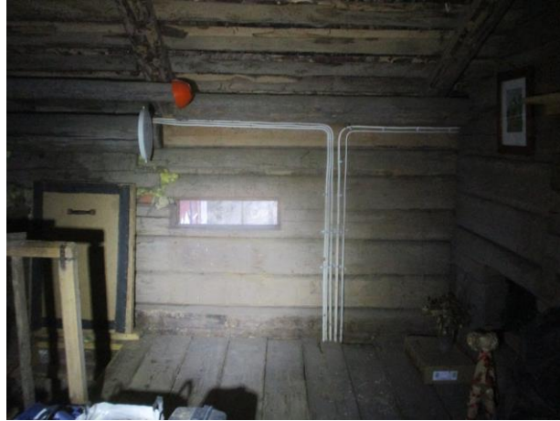
Kuva 11b. Uusittuja / lisättyjä sähköjohtimia.
