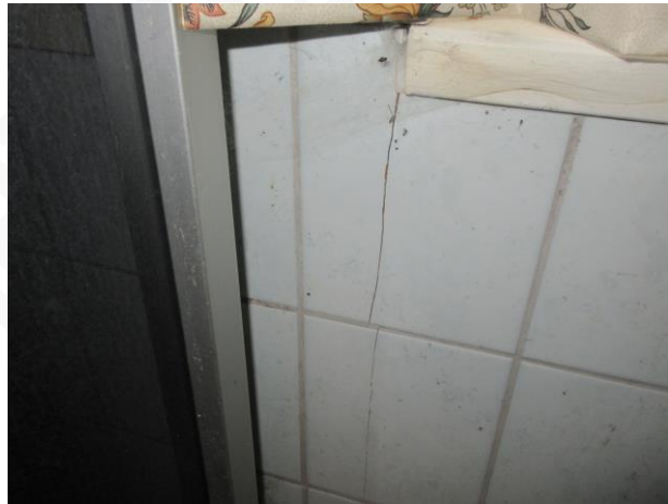
Kuva 5d. Halkeama laatoissa.
