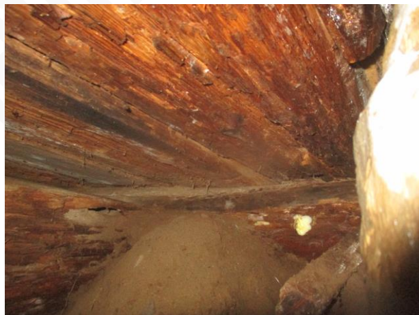
Kuva 1g. Lahoja laudoituksen alapinnassa.
