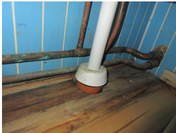
Kuva 5.3b. Viemärin läpivienti on epätiivis.
