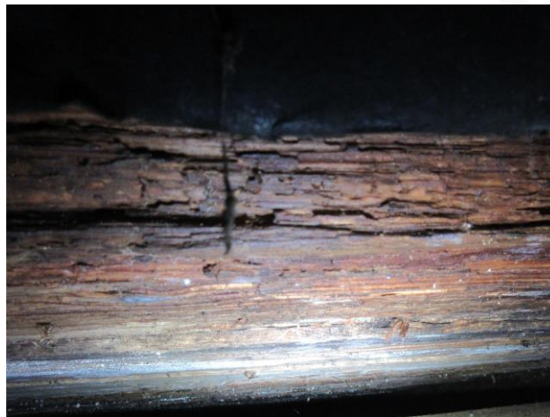
Kuva 1i. Pinnassa pehmentymää ja lahoakin..
