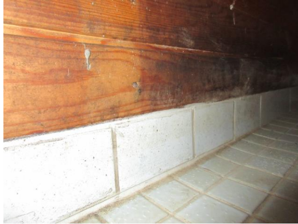
Kuva 5.2b. Paneloinnin tuuletusrakoa ei ole.
