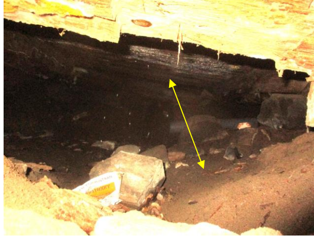
Kuva 1e. Voimakasta tummentumaa lattialaudoituksen alaosassa. Huom! Salamavalo saattaa vääristää hieman todellista tilannetta. Viite kosteasta maaperästä.
