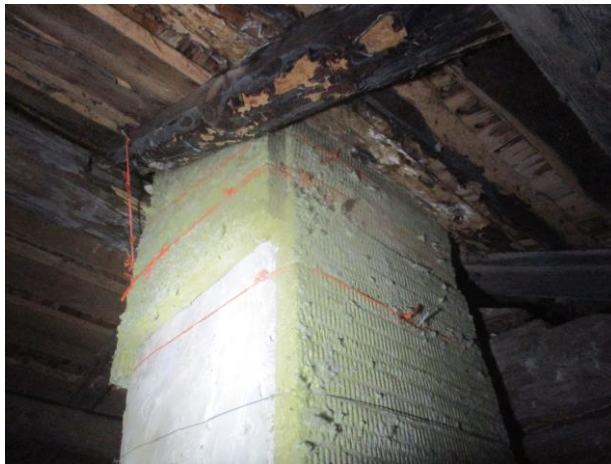
Kuva 4h. Vanhoja vuotojälkiä piipun läpiviennin kohdalla
