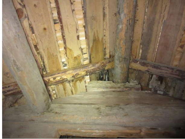
Kuva 4d. Vuotojälkiä harjan kohdalla.
