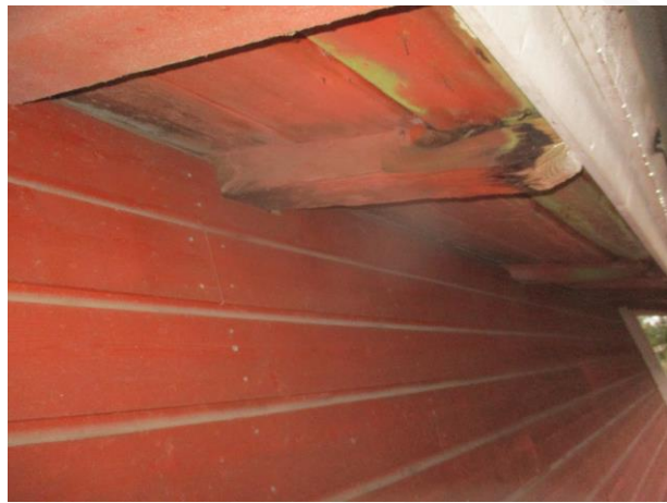
Kuva 4e. Räystäältä ei tuuletusta juurikaan virtaa.
